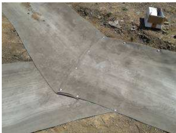
particolare punto di confluenza con ancoraggi
