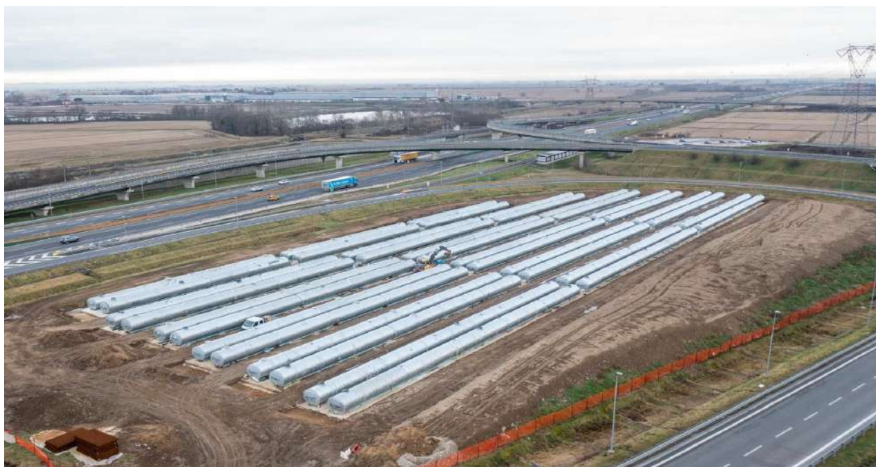
Novara : impianto accumulo e laminazione acque 9000mc
